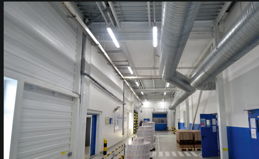
Производственный комплекс «DANONE»
